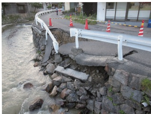
▶小田川の護岸が削られ道路が崩落Ⅱ山手町
