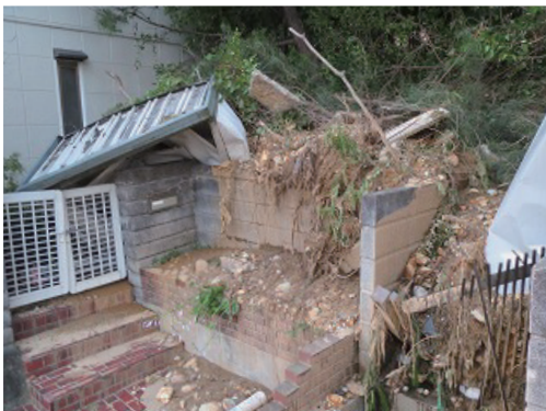
▶裏山が崩れ住宅に大量の土砂が流れ込むⅡ瀬戸町
