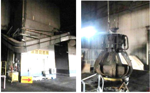
火災で焼け落ちたダクト・クレーン (市資料より)
