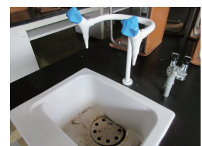
水が出ない理科室の蛇口
