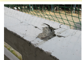
廊下の手すりに亀裂や穴
