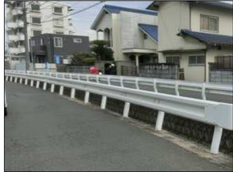
事例2: ガードレール
