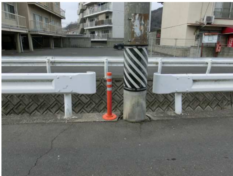
事例5: 隙間対策 (ポール等)
